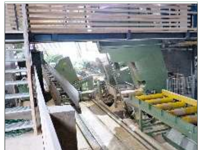
Ansicht der um 17° geneigten EWD-Blockbandsäge mit dem Zugang zur Steuerkanzel (links) Fotos: J. Härer
