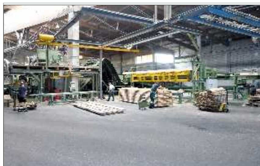
Die kompakte Anordnung von Blockbandsäge, Nachschnittsäge und Besäumer (im Bild links) lässt im Innern Platz für geordnetes Arbeiten.
